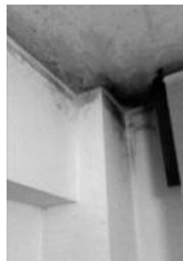
Filtracións e humidade
